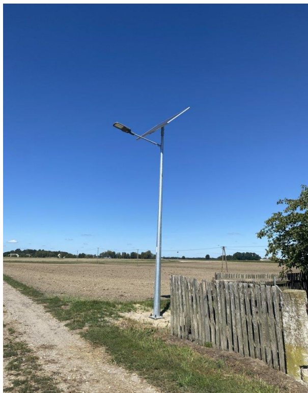
Lampa solarna w miejscowości Zalesie
