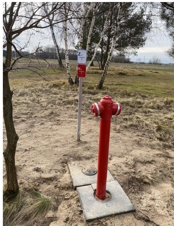
Elementy infrastruktury wodociągowej w miejscowości Tąsewy
